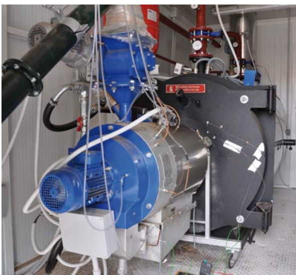
Conjunto caldera quemador.
