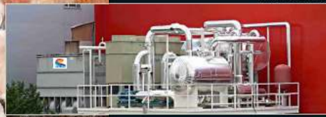
Refrigeración de procesos industriales
