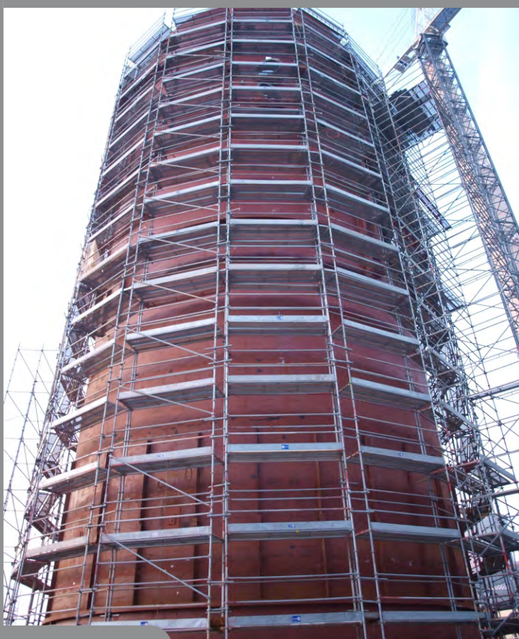
TERMOELÉCTRICA TURCENI - RUMANÍA
