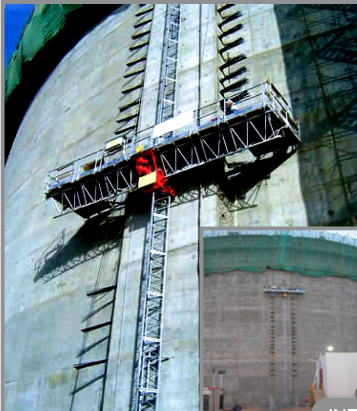
TANQUE ENAGAS - SAN ROQUE
