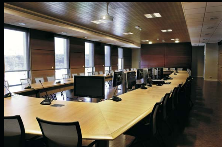
Escena para ver proyección: Luminarias centrales encendidas al 30%
