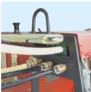
Conexión de agua hacia el sistema de accionamiento
