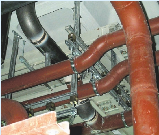
■ Soporte sala de bombas.
