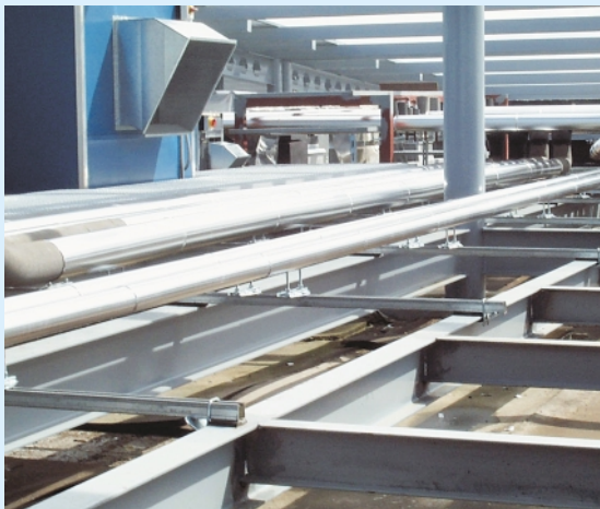
■ Soporte de tubería clima en cubierta.
