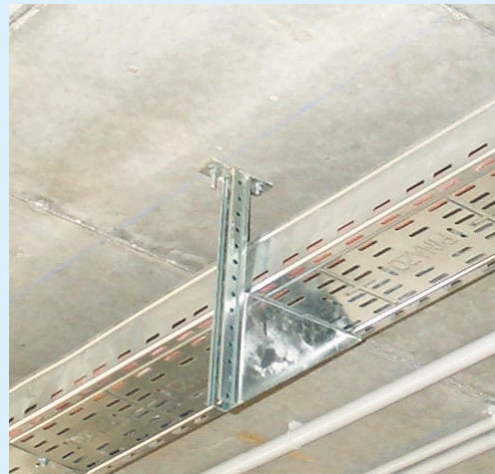
■ Soporte de bandeja eléctrica.
