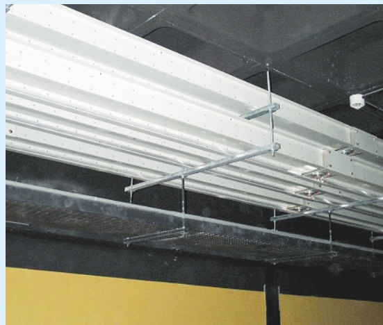
■ Soporte de blindosbarra y bandeja eléctrica.
