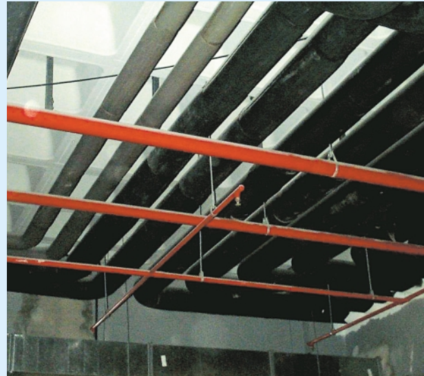
■ Soporte pared tubería PCI.
