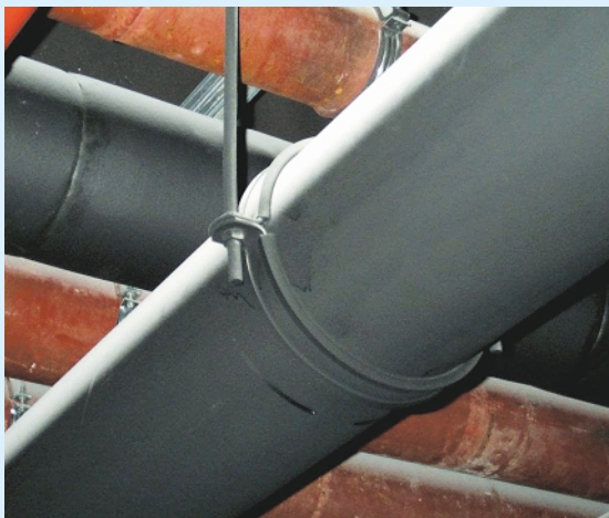
■ Soporte saneamiento en aparcamiento.
