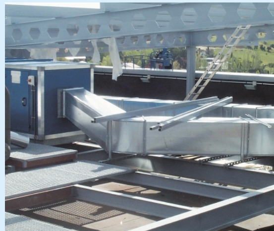
■ Soporte de conducto clima en cubierta.
