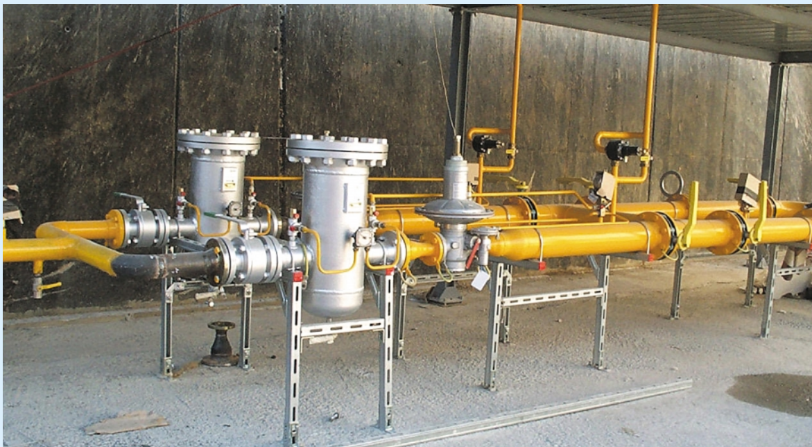
■ Soporte Instalación gas.
