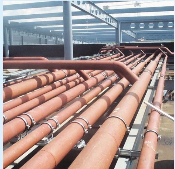
■ Rack tuberías en cubierta.
