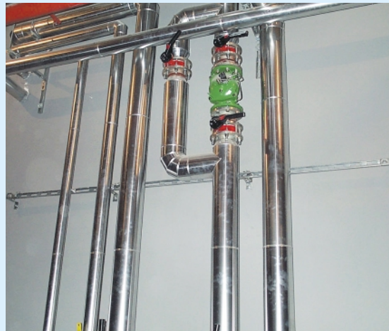
■ Soporte tubería en pared.
