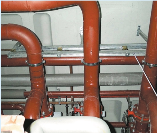
■ Soporte sala de bombas.
