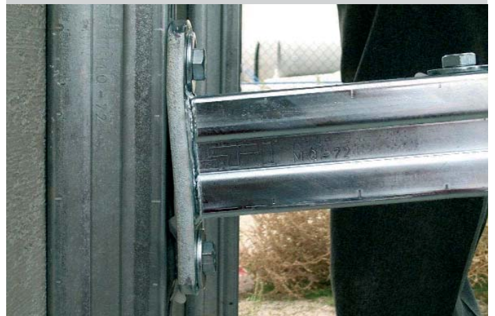
Vista del soporte tras carga de rotura
