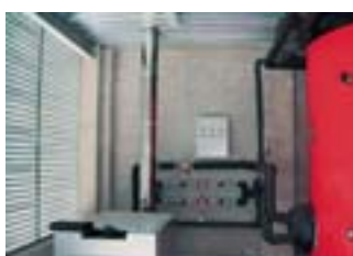
Sala de acumuladores, caldera e impulsión
