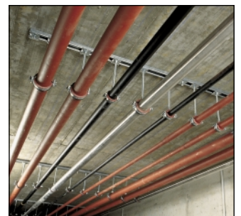
Suspensión de tuberías usando sistemas de carril
