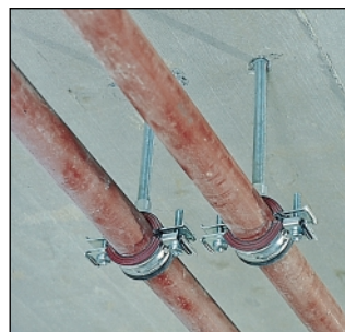
Suspensión de tuberías con anclaje y varilla roscada
