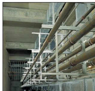
Estructura con sistema M para tuberías en distintos niveles
