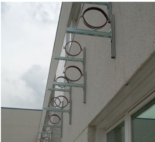
Colectores aéreos en muro de ladrillo.
