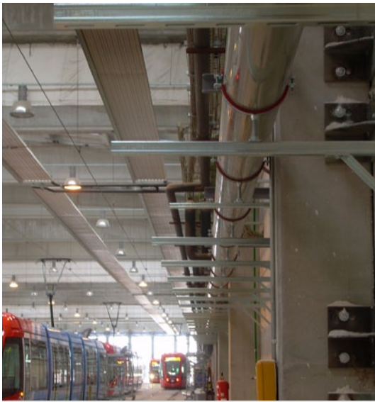
Colectores aéreos en nave de estacionamiento.
