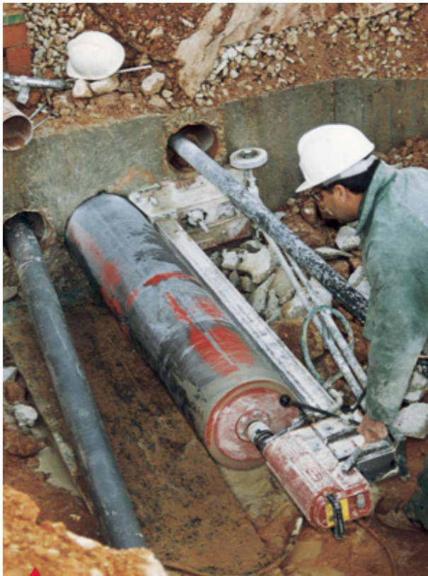
Top Diamant realizó 3 taladros de 3 m de profundidad en una zapata de hormigón armado con una DD 400 de Hilti.
