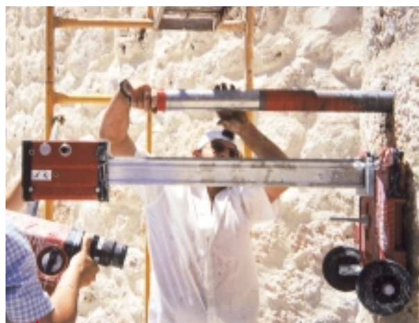
Alargamiento de la broca con tramos roscados hasta alcanzar la profundidad de 3 metros en roca.
