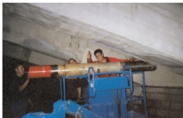
Extrayendo la broca roscada tras el trabajo. En la foto empleados de CASEVAL y el Formador de Diamante de Hilti.
