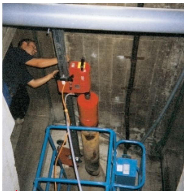
Vista del equipo DD 400 y la instalación de carriles anclados a la pared y al techo.
