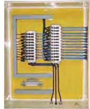
Cuadro de control, mando de actuadores neumáticos en Central Térmica.
