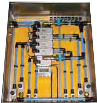
Cuadro de control para instalación de bateado de ánodos.
