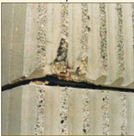
Fisuración causada por un manejo o colocación incorrecta de las piezas prefabricadas.
