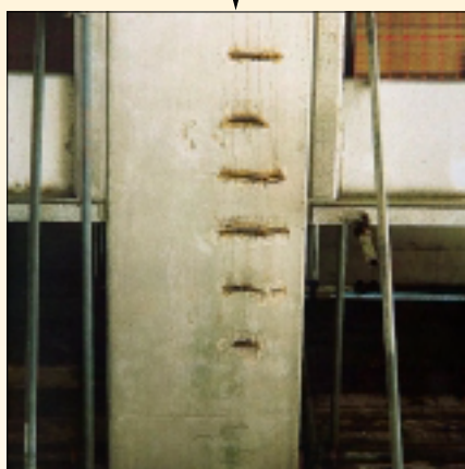
La corrosión de la armadura seguida de la disminución de la capacidad pasivadora del hormigón, por la carbonatación.
