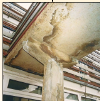
Efectos dañinos de la corrosión del acero acelerados por el acceso de cloruros de las sales de deshielo.
