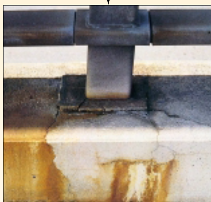
La corrosión de la armadura se muestra en forma de manchas de óxido, después de las fisuras producidas por la fijación de placas de acero galvanizado a los parapetos.
