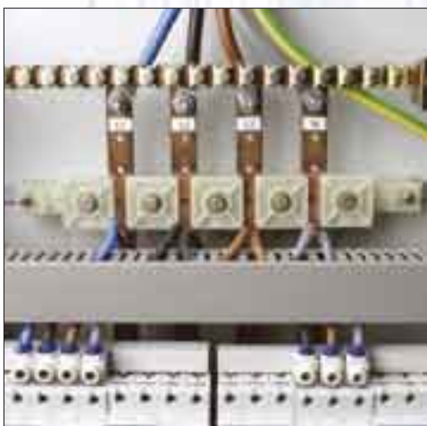
Instalación con soporte para embarrado de fondo que distribuye a conector de peines
