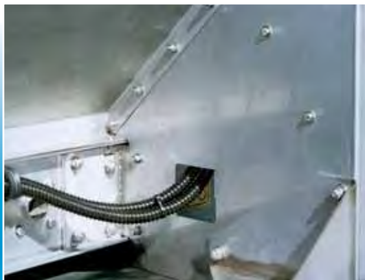
Estructura con plancha inox
