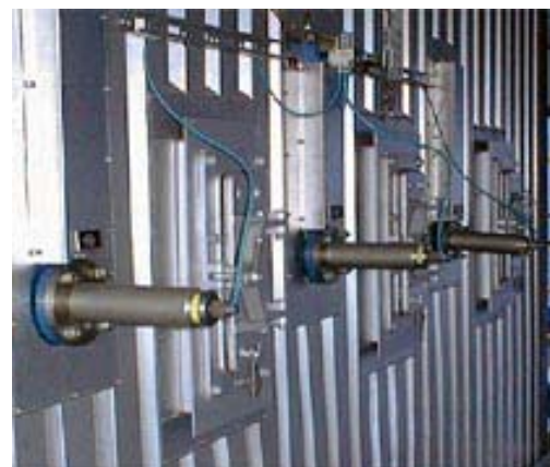
Salidas de filtros equipadas con PKL 220.
