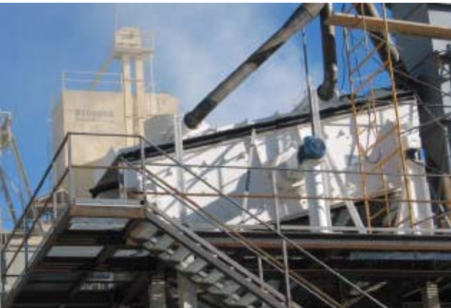
Cribas de accionamiento mecánico
