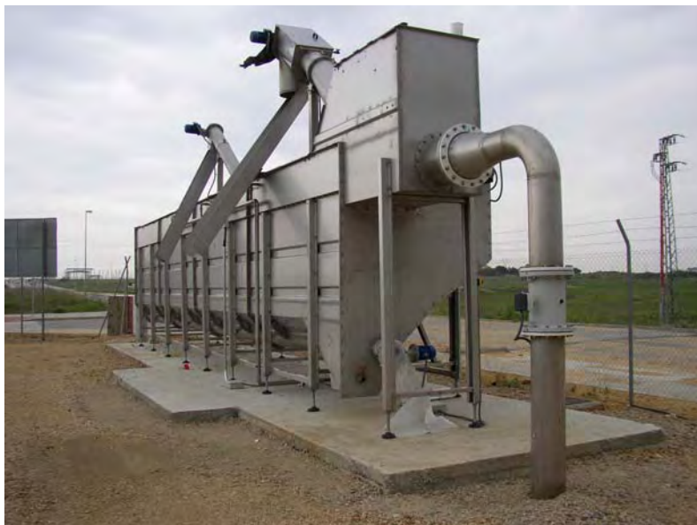
TSF 3/120 para el pretratamiento de la aguas residuales urbanas
