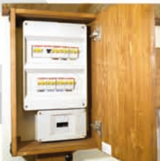
Instalación eléctrica según el Reglamento de Baja Tensión. (RD 842/2002)
