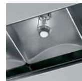
La presencia del anillo antideslumbrante aumenta el confort visual
