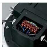
Doble PG, cableado pasante
