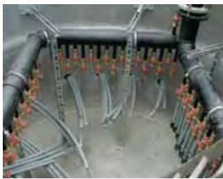
Fig. 25: Distribuidor para agua glicolada (en material polimérico)
