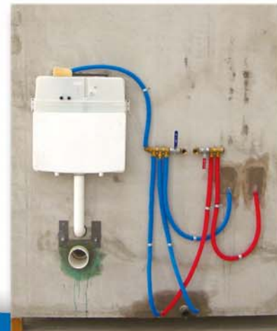
Espacio técnico Technical space
