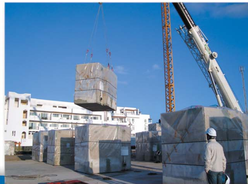
Ubicación de la célula de baño por forjados Placing of bathroom cell by forging
