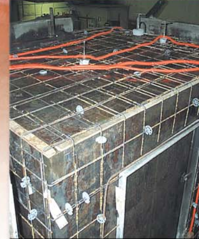
Instalación eléctrica Electrical installation
