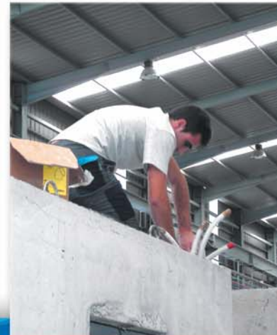
Cableado instalación eléctrica Electrical installation wiring
