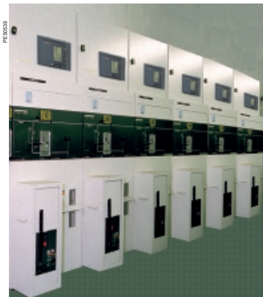
Control integral de equipos por Sepam.
