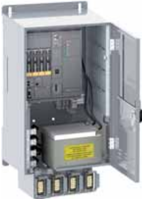
El equipo está alojado en un armario metálico montado en pared
