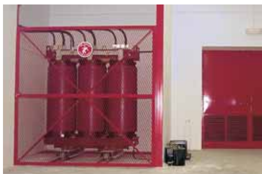
Transformadores Trihal (IP00) instalados en el recinto ferial de la Exposición Universal de Sevilla EXPO 92.
