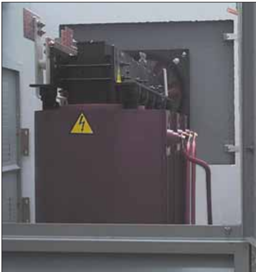
Vista exterior e interior de la ventilación forzada.
