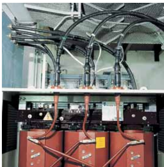
Conectores MT enchufables de 250 A y conectores separables en IP31.
