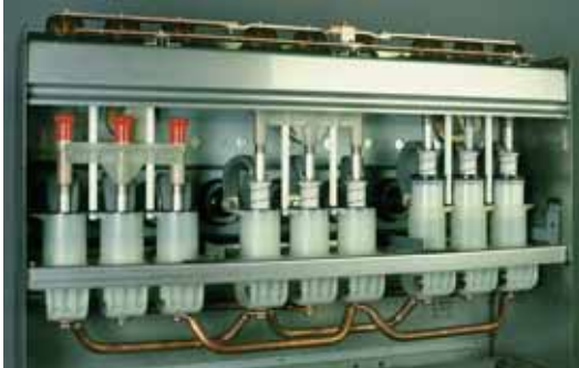
Interruptor de tres posiciones.
