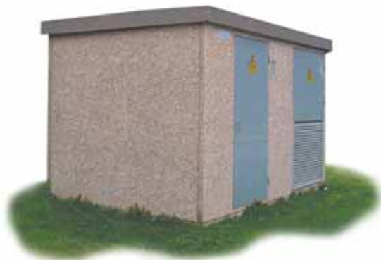
Vista frontal de un prefabricado tipo M1 CT1.
