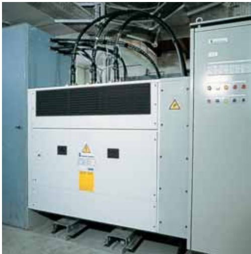
630 kVA-20 kV/420 V.
