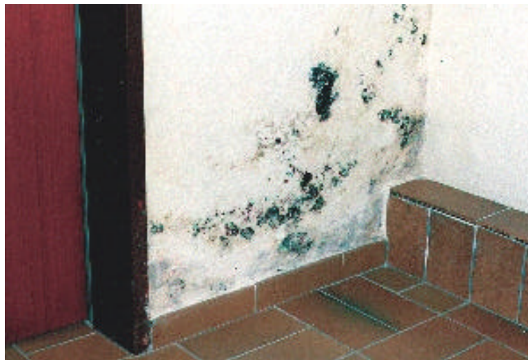
Figura 6 : crecimiento de moho sobre las paredes.
