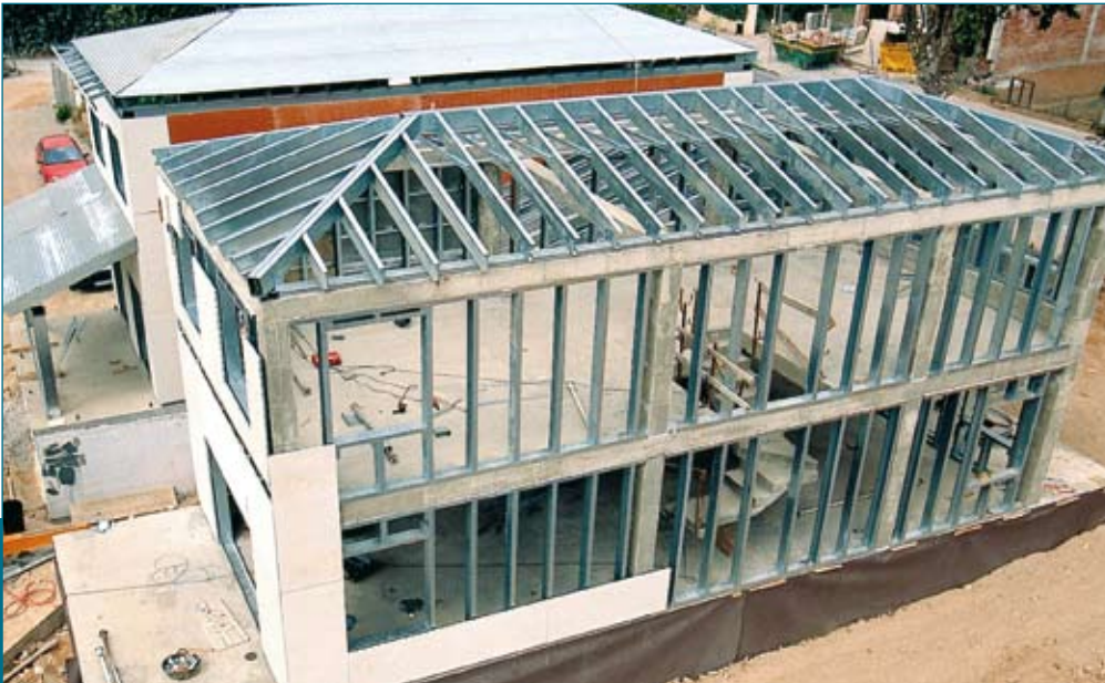
VIVIENDA DE ESTRUCTURA DE HORMIGÓN ARMADO Y SUB-ESTRUCTURA DE ACERO LIGERO GALVANIZADO.
