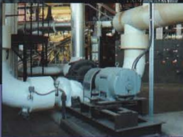
Alimentación de bombas
