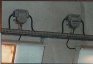
Alimentación de luminarias
