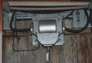
Cofre de derivación sin corte de la línea
