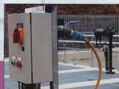
Tratamiento de aguas
