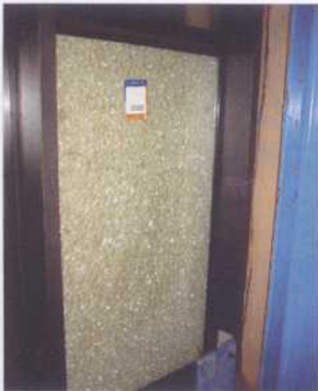
Detalle Vidrio Roto
