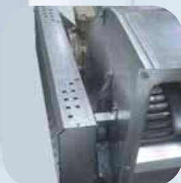
Transmisión por correas trapecoidales protegidas por chapa cubrecorreas
