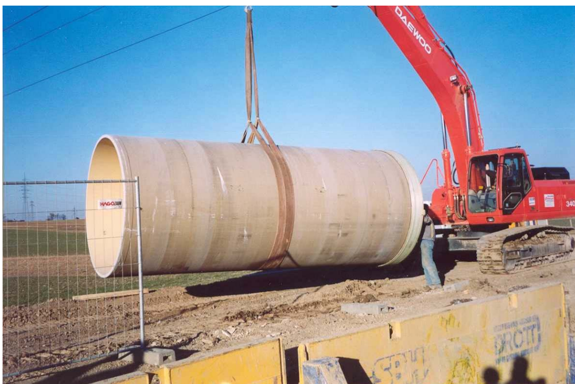
Fig.9 Incluso para los tubos más grandes, como el de la foto, de 2.400 mm de diámetro, el menor peso de la tubería reduce los medios necesarios para su montaje.
