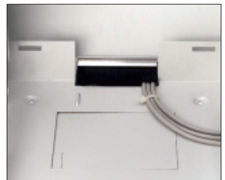
Se pueden instalar cepillos en las entradas de cables para evitar el polvo. Los cables se pueden fijar mediante bridas a soportes metálicos troquelados.
