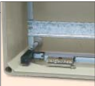
Vista interior sin panel protector con detalle de regleta neutro-tierras de los chasis modulares.
