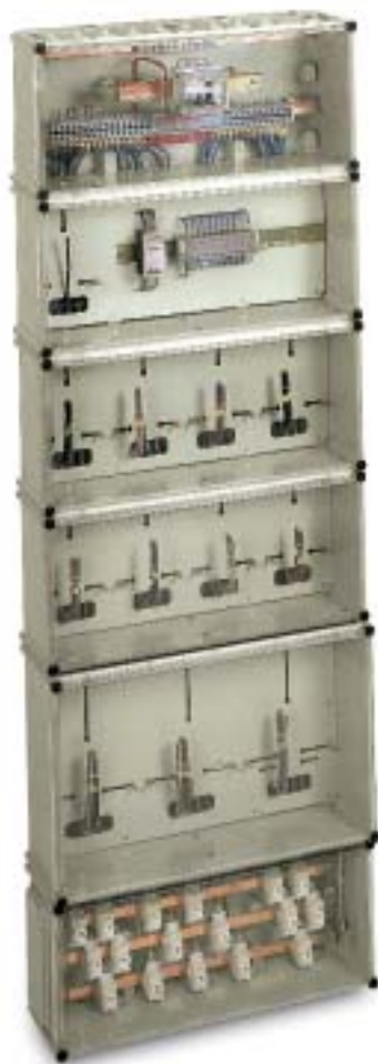
Centralización de contadores modulares
