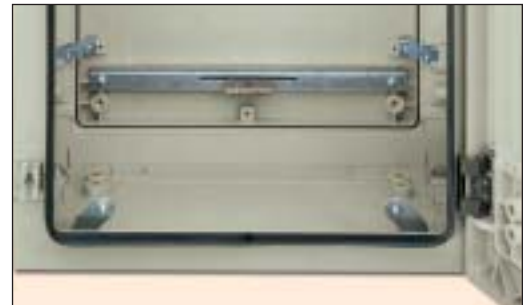
Detalle parte inferior armario con el conjunto regleta neutro, tierra de suministro estándar.
