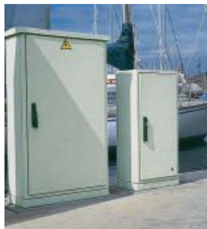
Distribución eléctrica y alumbrado público en puerto náutico deportivo mediante armarios PL.
