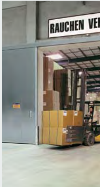
6 Puertas correderas cortafuego
