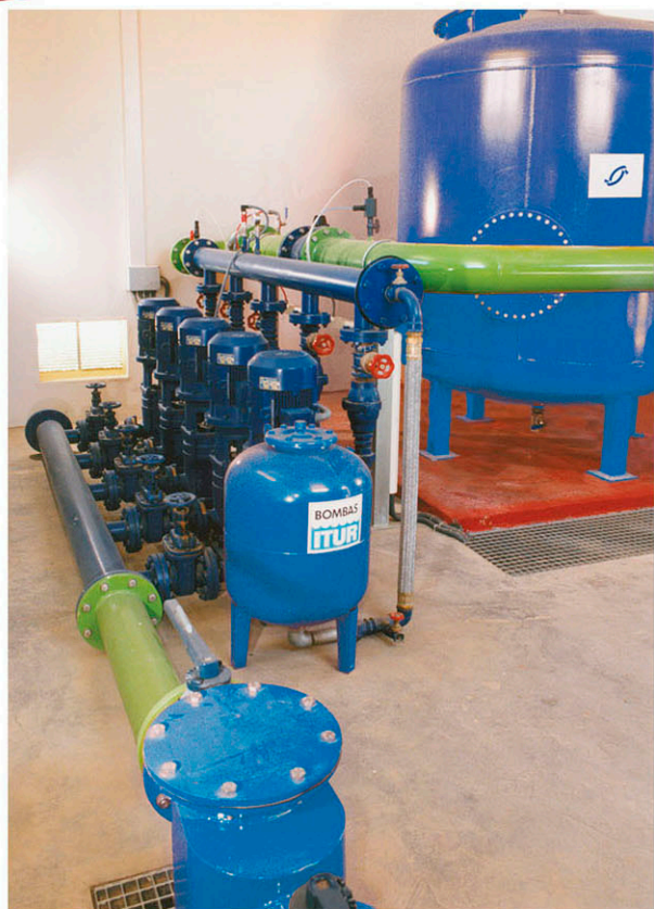
Sistema Válvulas Hidráulicas
