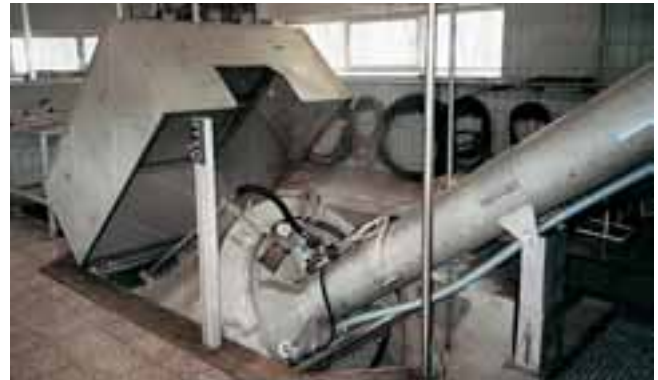
Instalación en el canal, con lavado de residuos y cubierta de acero inoxidable (contención de olores)
