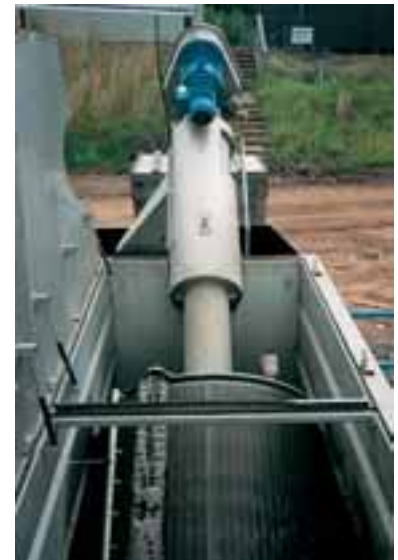
Derecha: Instalación en contenedor, protegida contra heladas (calefacción) hasta -25^{\circ} ; la limpieza de la malla se efectúa mediante agua a presión y cepillos
