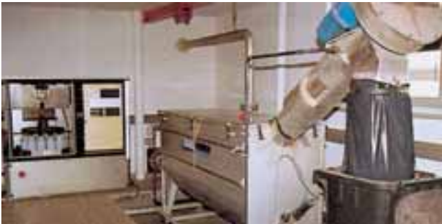
Planta de recepción de fangos con un sistema completo de medición e identificación, incluyendo un sistema de muestreo (opcionalmente registro electrónico automático)
