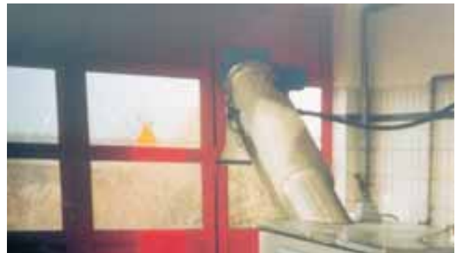
Planta de recepción de fangos ROTAMAT® en Londonderry / Irlanda del Norte
