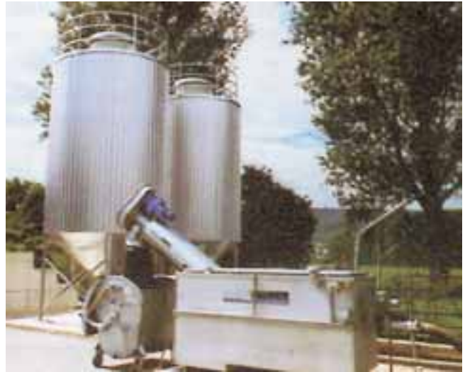
Tanque de almacenamiento, con protección contra heladas, para la regulación y el suministro continuo de fango a la planta depuradora
