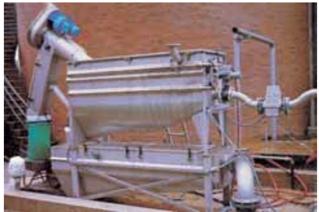
Planta de recepción de fango de fosas sépticas con desarenador
