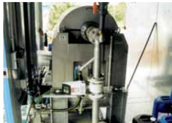
Instalación de centrífuga RoD 1500 en contenedor
