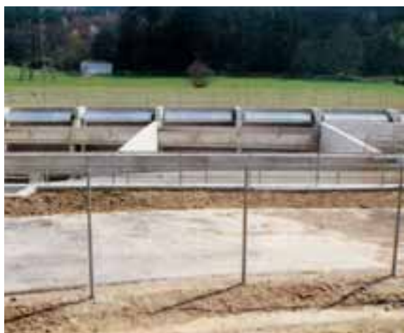
Tanque de tormentas con cámaras integradas para la instalación de volquetes.
