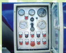
Cuadros de control y mando: dentro y fuera de la cabina
