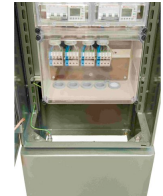
Espacio para conexiones
