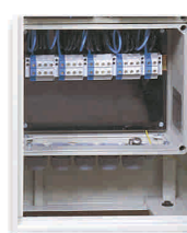
Espacio para conexiones
