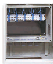
Espacio para conexiones
