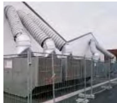
Climatización y calefacción
