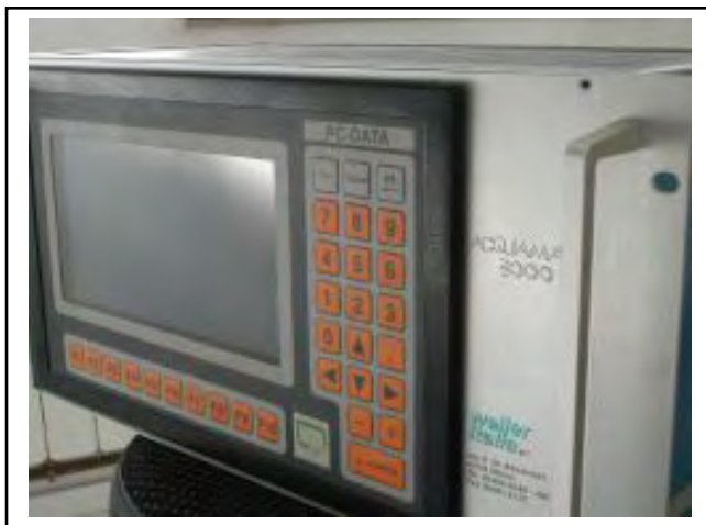
Control de Humedad instalación de mezclado. Batching Plant Humidity Control.
